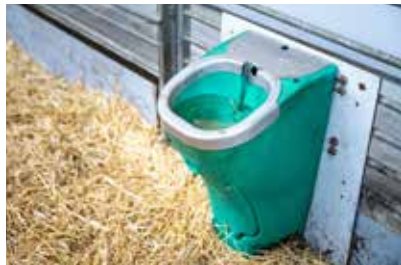
Vattenkopp fäst på platta som monteras på grind. Flyttbar i höjdlöd.
